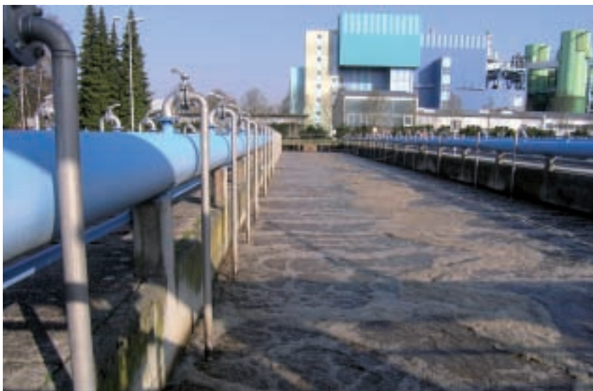
Optimierter Lufteintrag = Optimierte Betriebskosten und Umweltschonung
