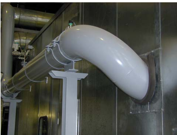
Bild 3: Typische Einbausituation – Staudrucksonde nach Raumkrümmer mit kurzer Einlaufstrecke
